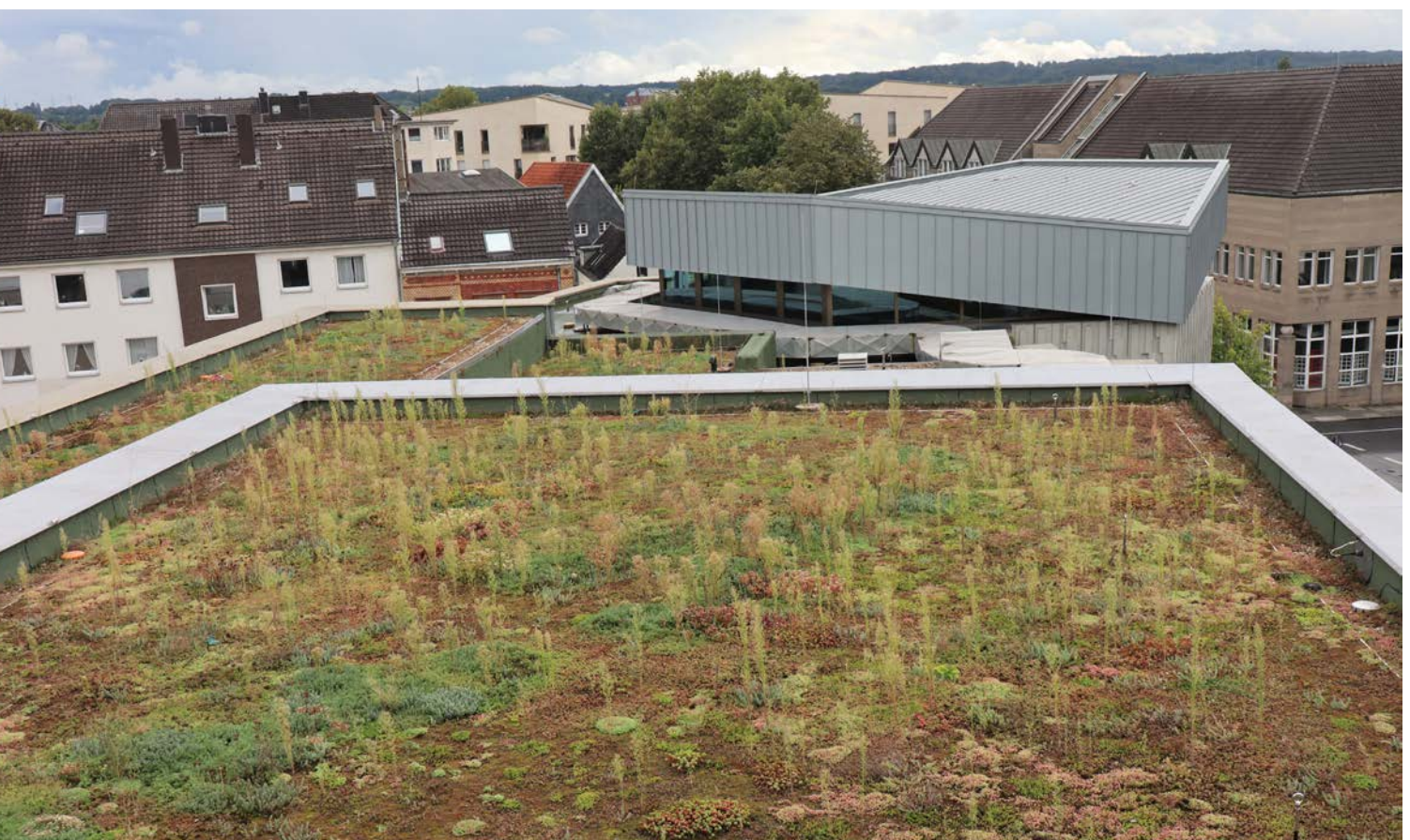
Abb. 14: Dachbegrünung auf dem Rathaus (Bild: Stadt Ratingen)
