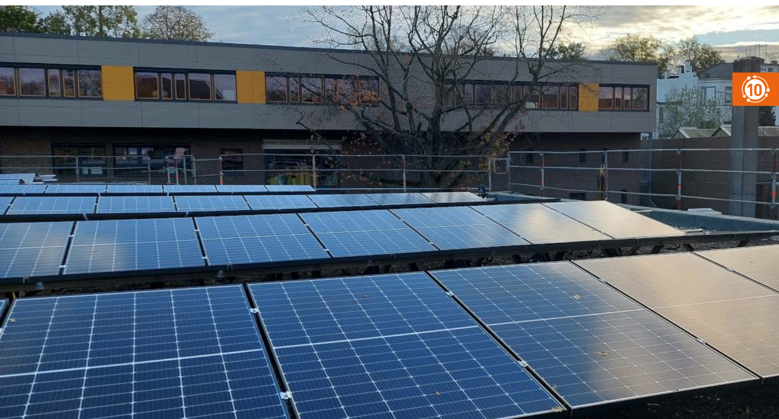
Abb. 8: Photovoltaikanlage auf der Prinz-Ferdinand-Schule (© Stadt Krefeld, Zentrales Gebäudemanagement)
