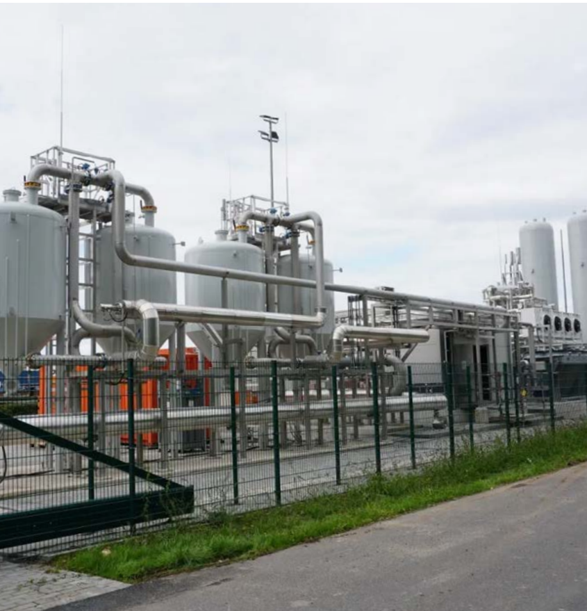
Abb. 9: Biogasaufbereitungsanlage (© SWK AG)
