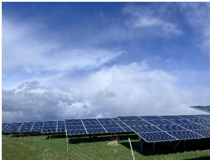
Abbildung 9: Solarpark / © Verbandsgemeinde Hachenburg
